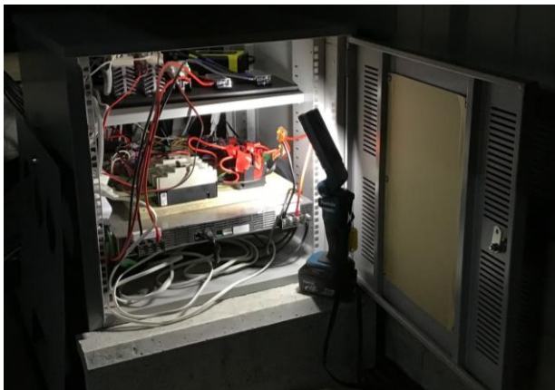
図 4 事業所屋内に設置した充放電器
